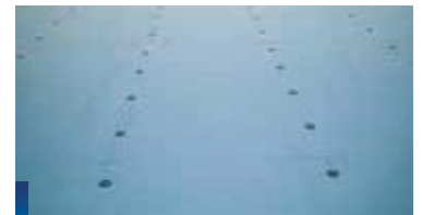
硬質ウレタンフォーム(イソシアヌレートボード)断熱材を金属下地屋根に敷き込んだ後、機械固定した状況事例
