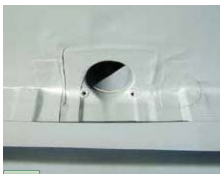
9 Dドレン部シート納め 塩ビディッピング加工してあるため、シーリングに頼らない納りが可能。 IBシートと一体化できる。
